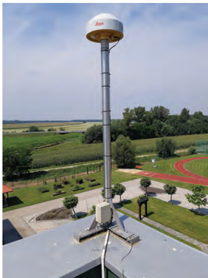
Antena GNSS, nameščena na strehi stavbe Dvojezične srednje šole Lendava
